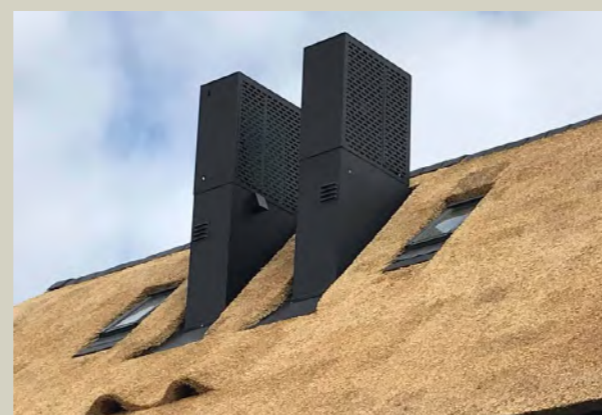
Slim: warmtepompunit (die vrij moet kunnen luchten) geïntegreerd als schoorsteen.
