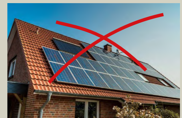
Niet zo: achteraf rommelig opgeplakte PV-panelen
